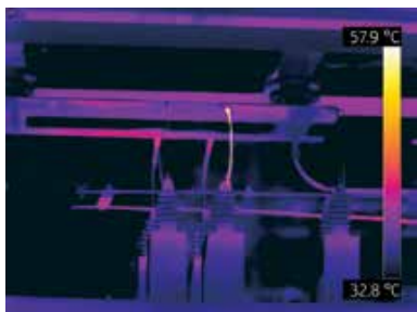
Gorący przewód zasilania transformatora
